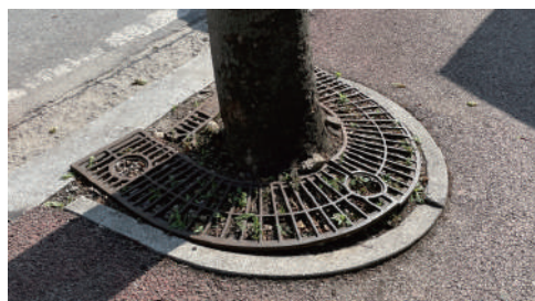
지양 수목의 성장으로 인한 균열 발생
